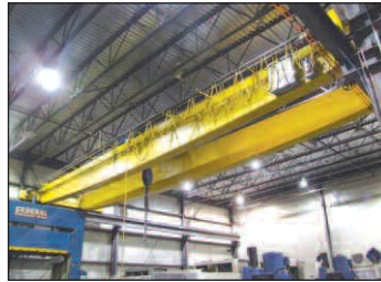
25 ton REDDY O.H. Crane
